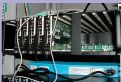
さくらインターネットの専用サーバーは、超小型のサーバーマシンを用いることで低価格を実現している。3Uのシャーシに12台のマシンを搭載でき、1台のラックに120台のサーバーが収納できる。
