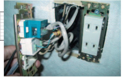
まったく配管のない建て売り住宅で、やむなく先行配線されていた4芯の電話線にRJ-45コネクタを取り付けてイーサネット化した例。距離が短いため100BASE-TXとして使っている。もちろん規格外の使い方だ。
