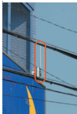
屋外の無線LANアンテナ。PCショップの壁に直接取り付けられている。
