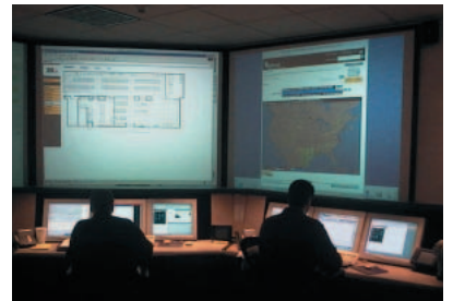
建設に5,000万ドルもかけたというzixitセキュアデータセンターの監視システムの様子。このデータセンターは、200万回 / 時の公開鍵の配送、100万通 / 時のメール保管、1億3000万個以上のメールアドレスに対応する公開鍵保管といった能力を持つという。
