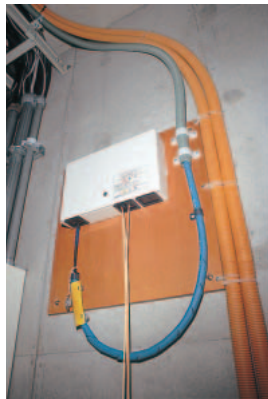
外との光ファイバーの信号を屋内仕様に切り替える装置。
