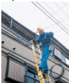
工事担当者が光ファイバーを家まで引っ張ってきてくれる。
