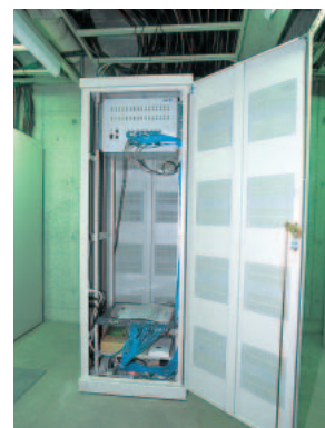
MDF室にHomePNAの機器が設定されている例。通常のMDF室には、電話に係るNTTの機器のみが設置されている。FTTHの接続業者がNTTだと問題はないが、NTT以外の場合はMDF室に関する管理規約をチェックしておきたい。
