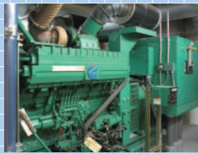
(左) CVCF (安定供給可能な) レベルのUPS (無停電電源装置)。(右上) ガスタービン方式の自家発電装置。(右下) 24時間体制の有人運用監視システム。
