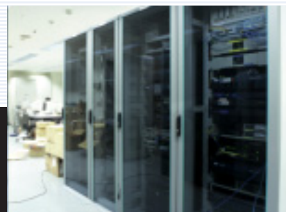
岡山情報ハイウェイのNOC。県の機材だけでなくプロバイダーの機材も置かれている。
