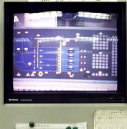
湯島ポンプ所を遠隔監視するITV。ポンプ所の制御部分を映し出している。古い型のため、画面切り替えには少々時間がかかる。
