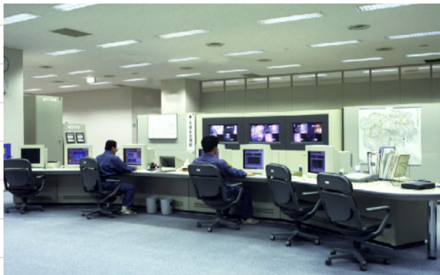
有明処理場内の遠隔監視部。画面を分割して複数のポンプ所の様子を管理できるようになった。
