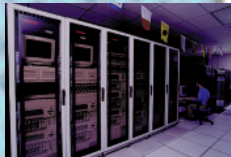
ケージに収められたサーバー群
