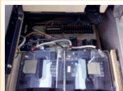
電源を供給するためのバッテリー。ダイナモを使って発電された電気が貯えられている。
