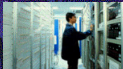
社内にあるCATV用のサーバー
