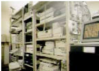
① パーティションで区切られた研究室の隣にある、ネットワークを管理するマシンルーム。
