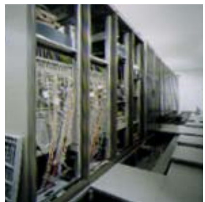
◎ ルーターやコンピュータがぎっしりと詰まったNSPIXPの心臓部ともいえるラック群。
