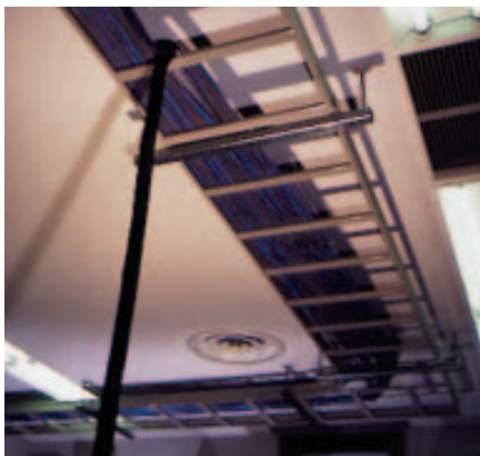
ラダーで配線した例
