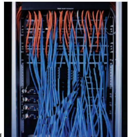
パッチパネルの例
